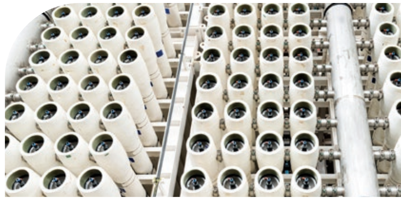
Tubos de presión de ósmosis inversa de una planta desalinizadora (Foto: SONAMI)
